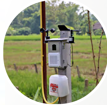
▲ การติดตั้งเครื่องวัดฝุ่น PM2.5
